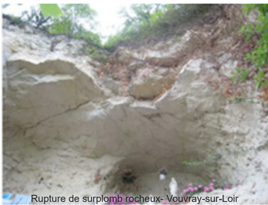
Rupture de surplomb rocheux - Vouvray-sur-Loir
